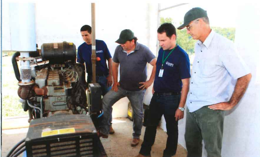
Gerador de 120 KVA para o fornecimento de energia elétrica para a propriedade
